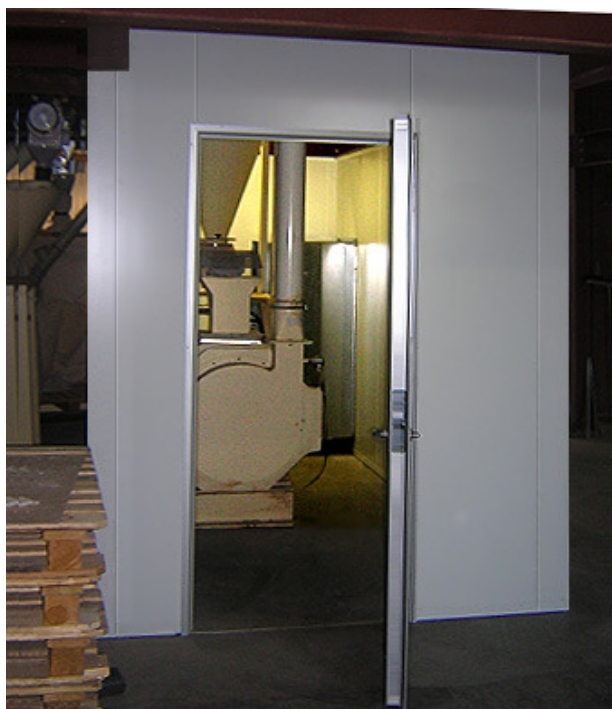
Encoffrement d'un broyeur à attrition - Boulangerie industrielle
